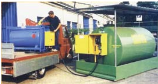
DEPÓSITOS HOMOLOGADOS FIXOS E DISTRIBUIDORES DE COMBUSTÍVEL
